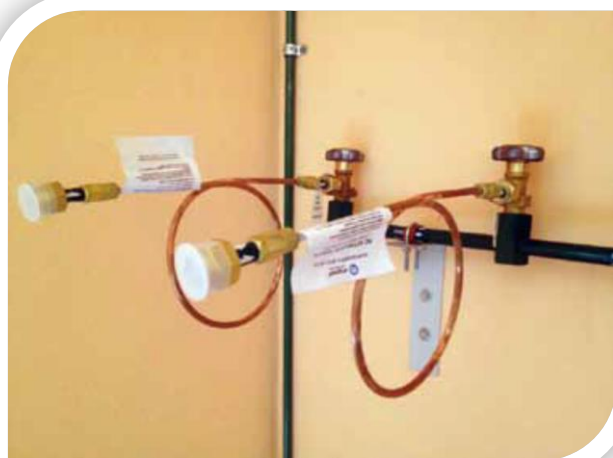
BANCADA CON ARCOS DE CONEXIÓN RÍGIDOS
