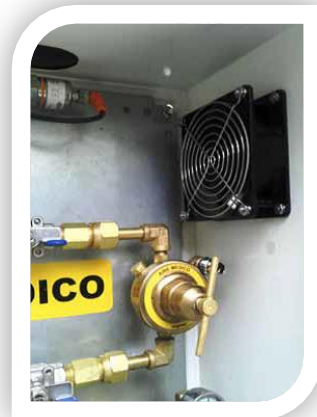
FUENTE DE VENTILACIÓN ELÉCTRICA
