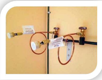
BANCADA CON ARCOS DE CONEXIÓN RÍGIDOS
